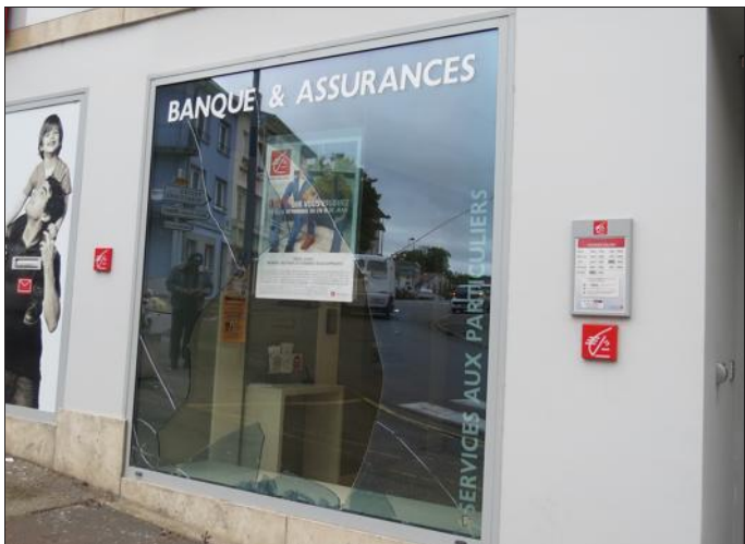
La vitrine de la Caisse d'Épargne a notamment été brisée. Photo RL
